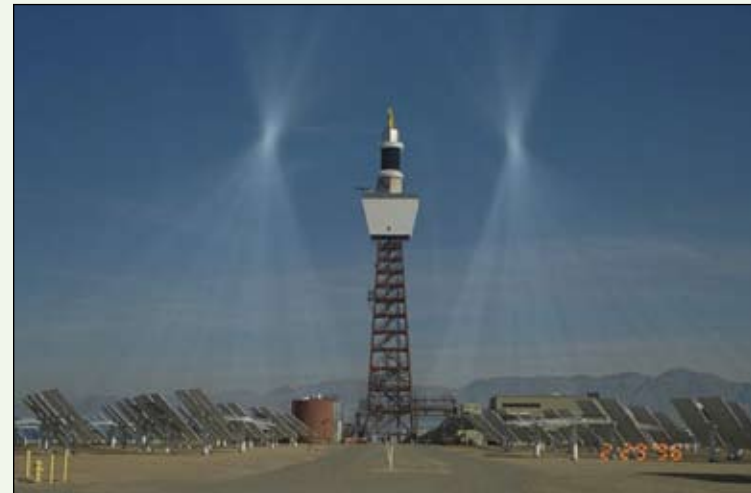
Een torencentrale met heliostatische spiegels (foto Sandia).
